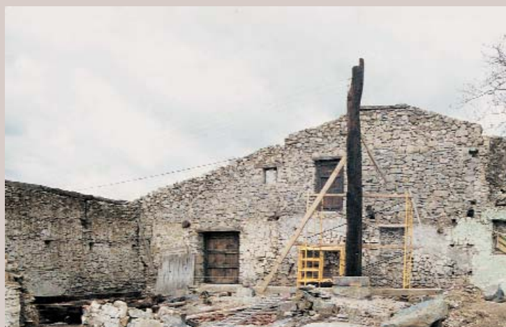
Lanen ikuspegi atsekabegarria: Zutabeen azpiko zatia ustelduta zegoenez, egitura osoa desmuntatu behar izan zen.
